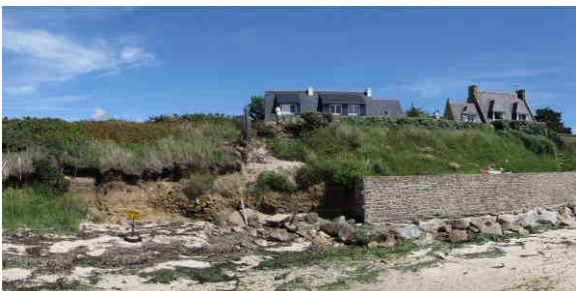
Figure 2 : Erosion de la falaise littorale à Pors Breign près d'un enrochement (photo : M. De Baets)
